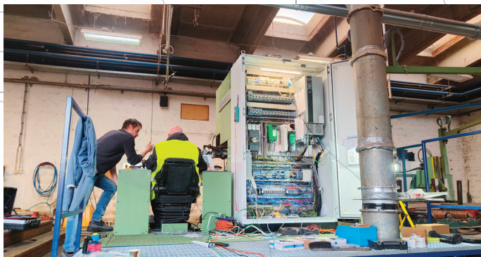
Prenova je vključevala elektro in strojni del, poseben izziv je predstavljajo sprotno programiranje na terenu.
